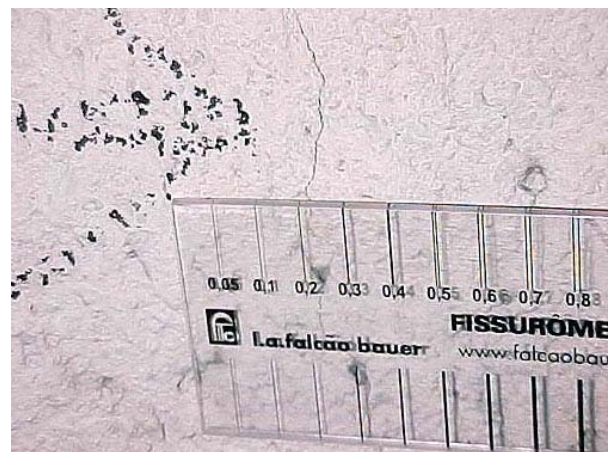
Fig. 17 – Abertura de fissura de 0,2 mm em peça de concreto
