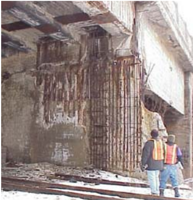
Figura 1-Estrutura de betão de CPN em elevado estado de degradação
