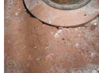
Figura 26 – Solo-RCD – ruptura localizada
