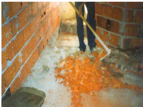
Figura 1 – Alvenaria de vedação tradicional: desperdício de tijolos cerâmicos
