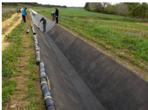
Fig. 7 - Vista de canal da Fig. 6 de betão reabilitado com membranas betuminosas
