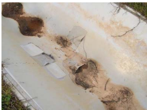
Fig. 12 - Vista de válvulas “clapê” em membranas de PVC
