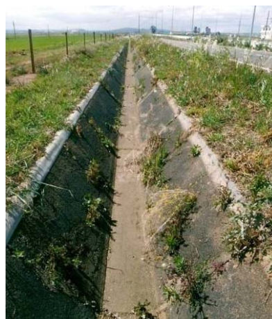
Fig. 9 - Vista de um canal e da vegetação ao longo das margens e nos materiais betuminosos de revestimento
