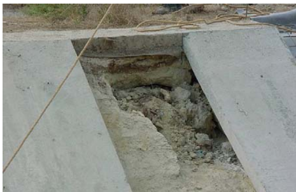
Fig. 15 - Deficiente compactação da camada de solo de suporte do revestimento de betão de uma espalda
