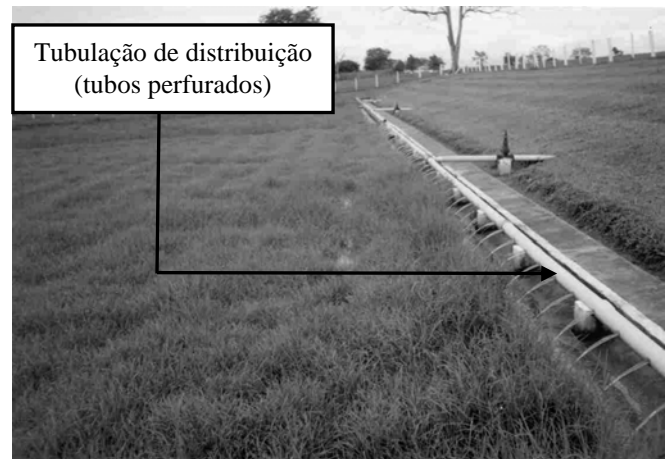
Figura 3 - Vista da tubulação de distribuição adotada na estação de tratamento da cidade de Populina, Estado de São Paulo, Brasil.
